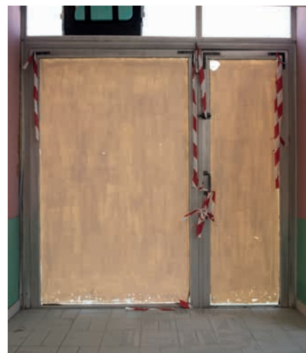
3 - Des portes condamnées qui ne résistent pas aux intempéries
