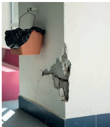
2 - Des murs en décrépitude et des poubelles remplacées par des pots de peinture
